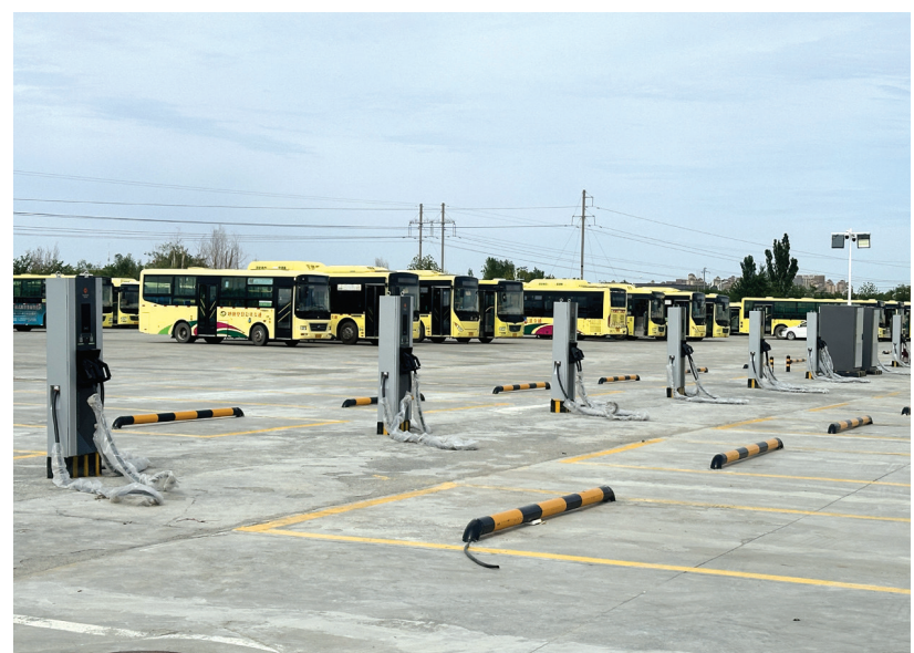
图为呼图壁县首个公交车充电站——千拓新能源公交公司停车场充电站。 □刘玉洁摄
