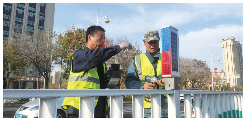
昌吉市市政养护工人在宁边西路的一处路口安装爆闪安全警示灯。
