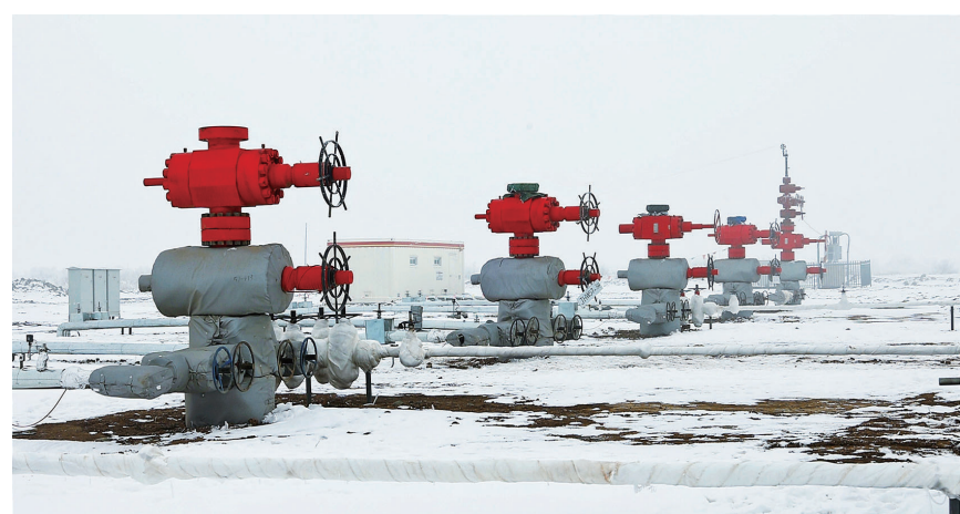
中国石油新疆油田公司吉庆油田作业区，页岩油57C平台自喷井正在生产。
