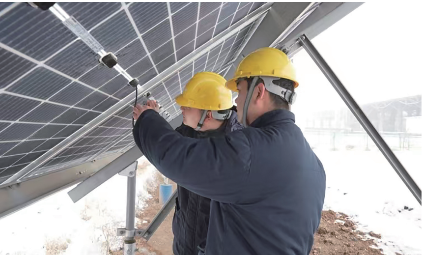
在新疆嘉润资源控股有限公司，两名技术人员正在维护5.9MW分布式光伏项目相关设备。 □邢振江摄
