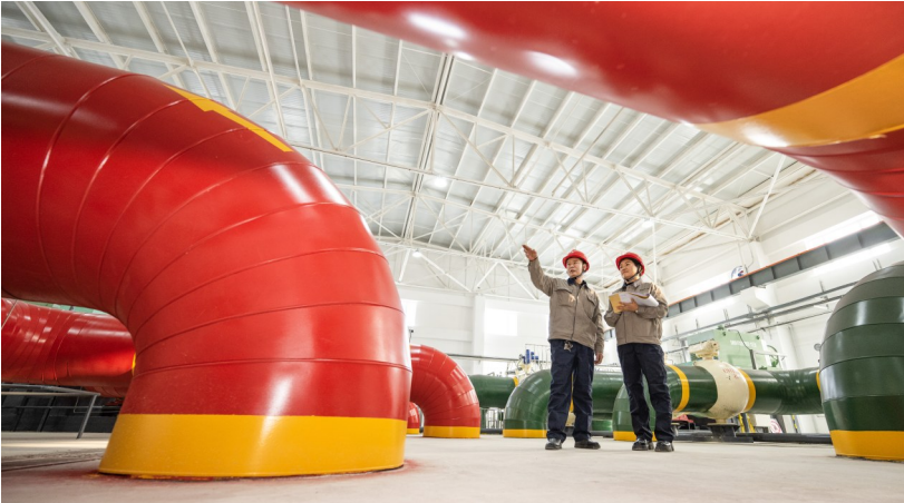
2024年12月27日，昌吉市新建立输管网供热项目2号继泵站，工作人员在巡查设备运行情况。 □本报记者 何 龙摄
