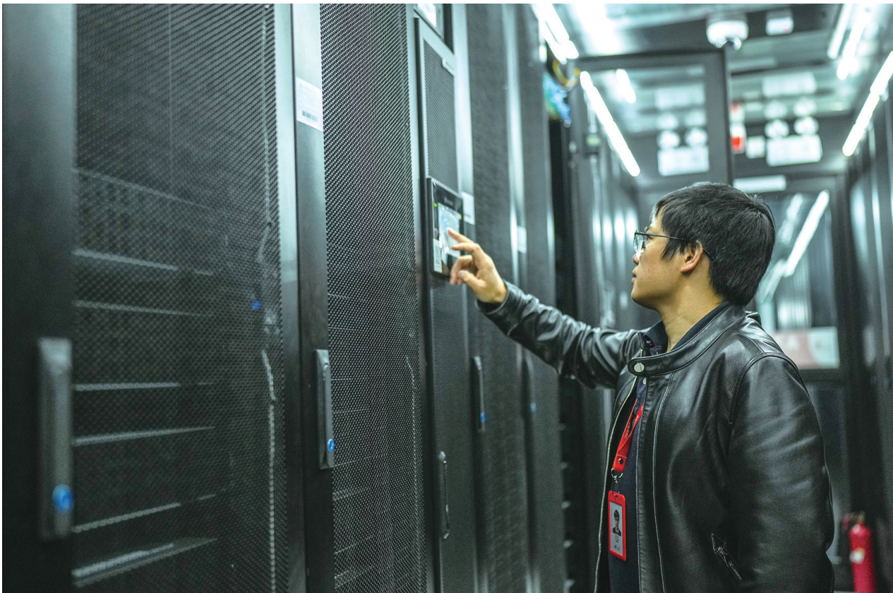
工作人员在位于贵州的中国联通贵安数据中心微模块机房进行巡检。
