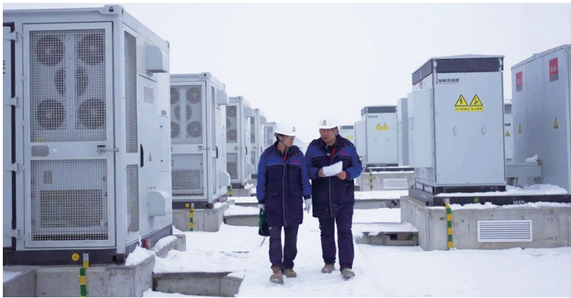
2月3日，工作人员在昌吉国投阜康20万千瓦/80万千瓦时共享储能项目现场巡检。 □李佳俊摄
