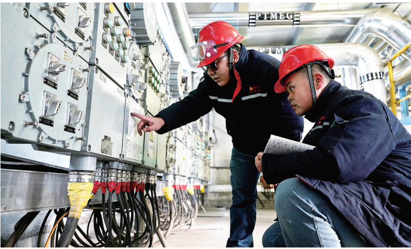
图为新疆国泰新华化工有限责任公司员工王鑫(左)和张喧正在检修电气设备。
