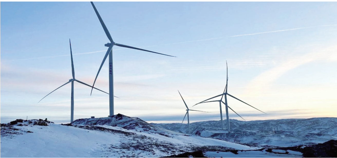
木垒县大石头乡东方风电100万千瓦风电项目。
