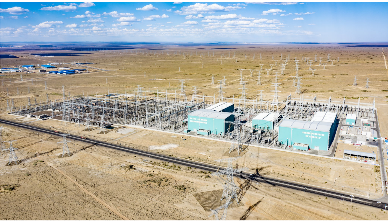
昌吉—古泉±1100kV特高压直流输电工程是新疆准东煤电基地电力大规模外送 的配套工程，是世界上电压等级最高、输电距离最长、输送容量最大、技术水平最先进的直流输电工程。
