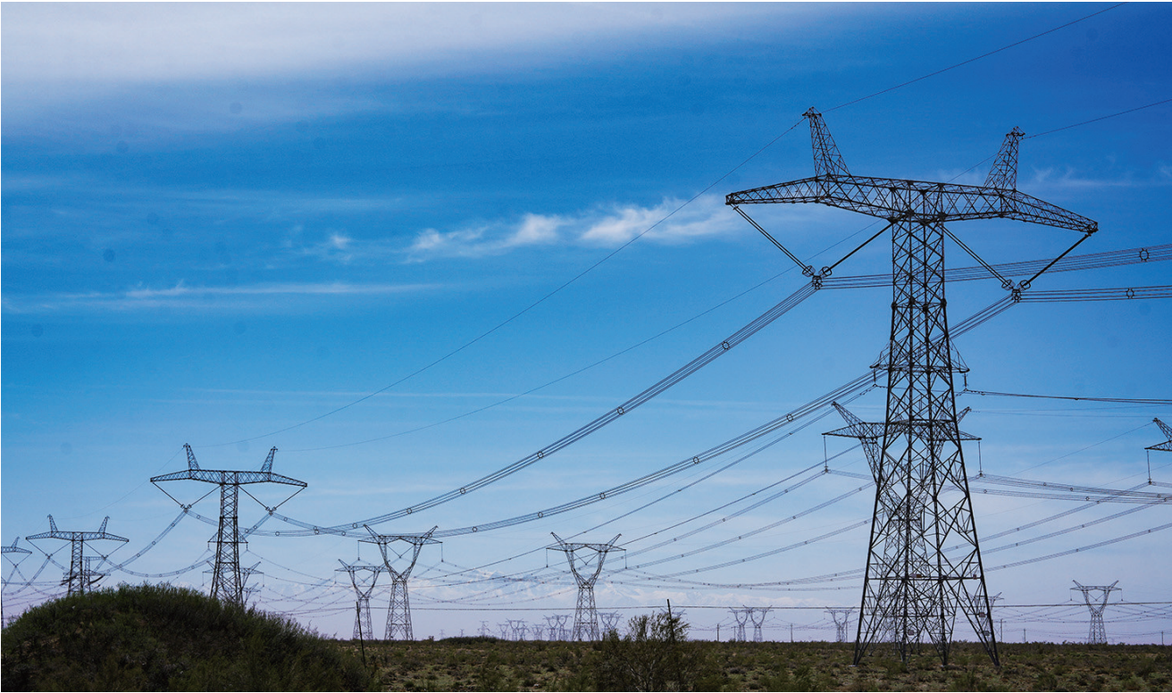
新疆电通过昌吉—古泉±1100特高压直流输电工程昌吉换流站输往华东地区。
