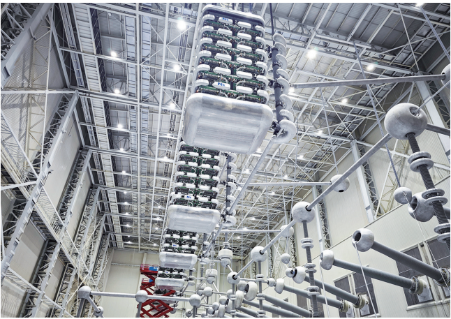
“疆电东送”昌吉换流站极1阔厅。
