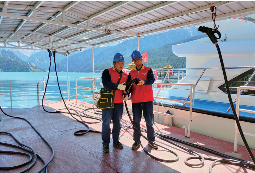
5月29日,天山天池景区,国网阜康市供电公司九运街供电所工作人员正在检查充电船用电设备。
