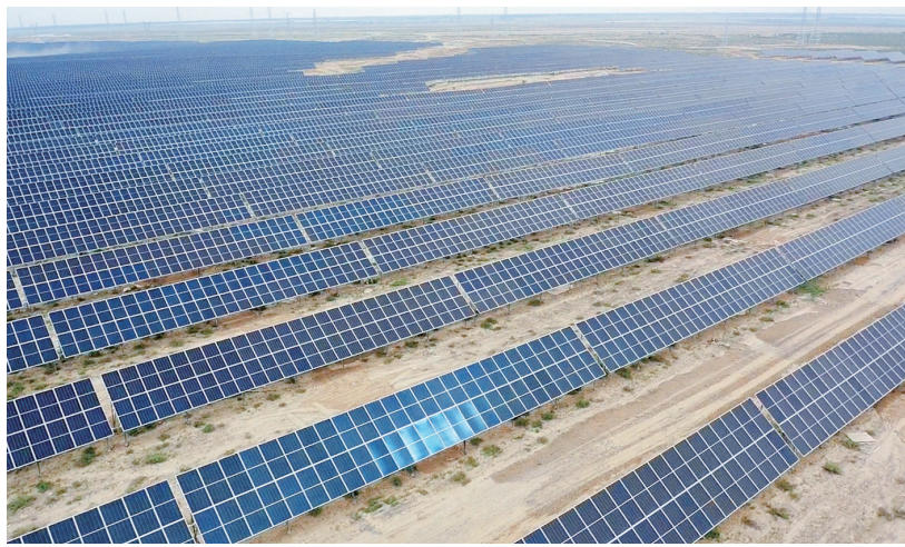
图为中电呼图壁县30万千瓦源网荷储一体化光伏复合项目。
