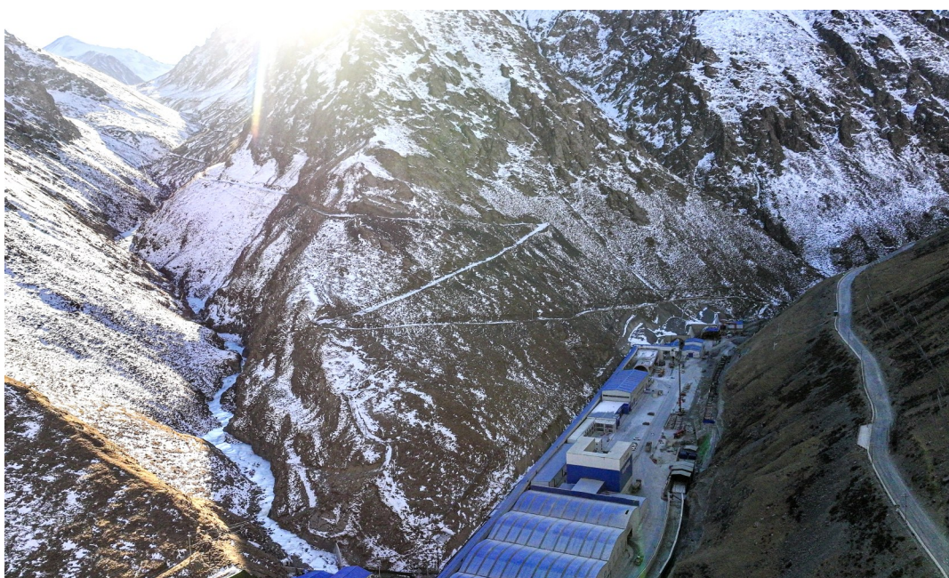
这是在新疆乌鲁木齐县拍摄的建设中的乌尉高速公路天山胜利隧道入口端(2024年12月20日摄，无人机照片)。
