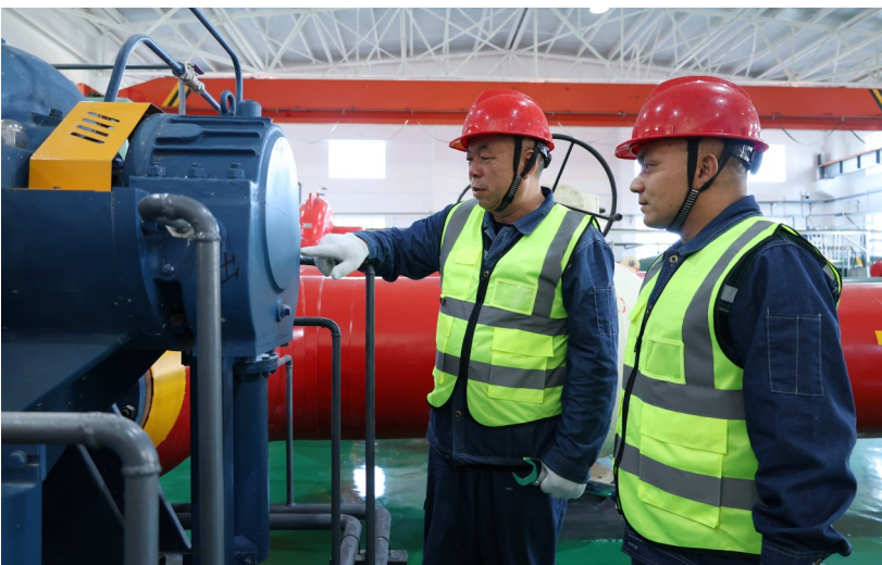
近日,在昌吉市新建长输管网供热项目2号中继泵站,工作人员正在检查供热设备的性能。
