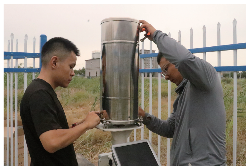
技术人员正在安装调试自动气象站设备。
