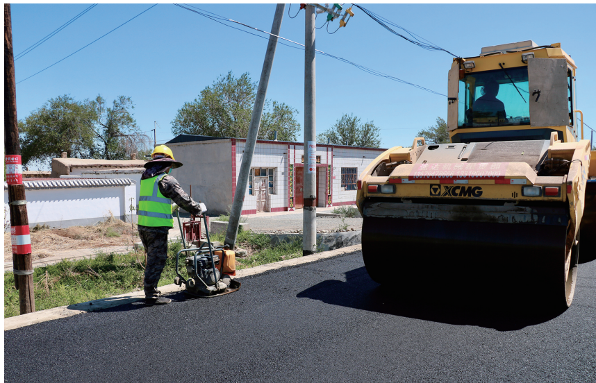
近日，在吉木萨尔县Y085乡道庆阳湖乡东庆村段，工人们在进行道路沥青铺设工作。 □张鑫源摄
