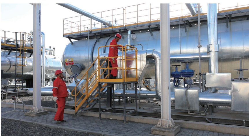
近日，新疆油田吉庆油田作业区工作人员正在巡检。
