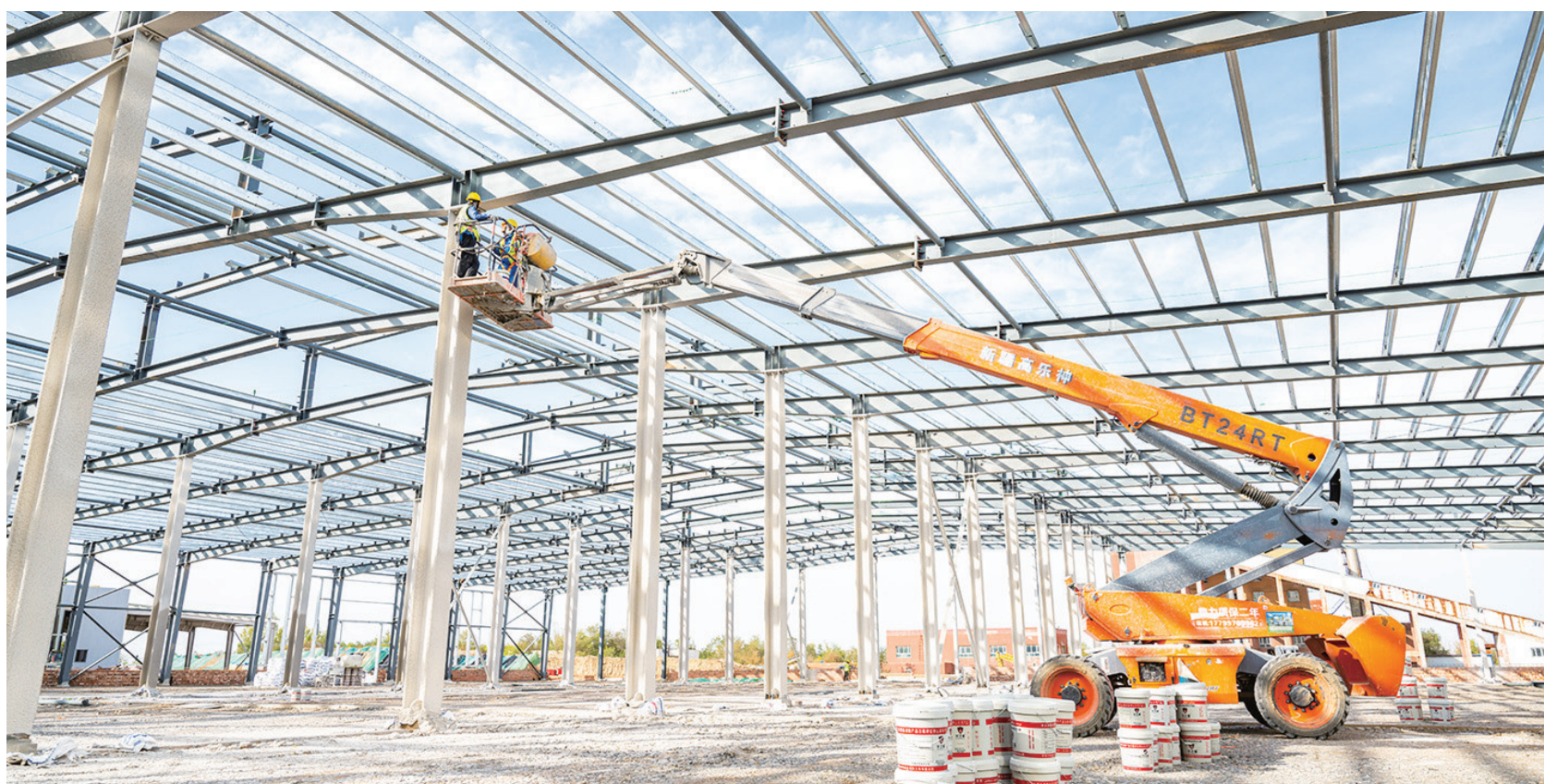
10月9日,昌吉国家高新技术产业开发区,新疆国经事业新发展股份有限公司年产5.2万吨番茄制品项目现场,工作人员正在建设钢结构厂房。项目建成后,预计可直接提供就业岗位300余个。
