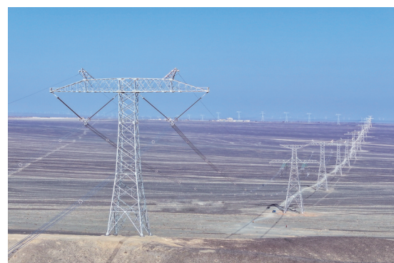
上图：矗立在戈壁上的±800千伏哈密—重庆特高压直流输电线路工程（无人机照片）。
