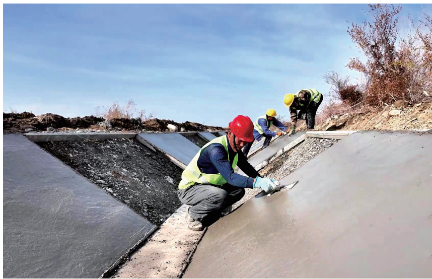
近日，玛纳斯县乐土驿镇高标准农田配套斗渠建设现场，工人正在进行浇筑边板作业。 □朱文斌摄
