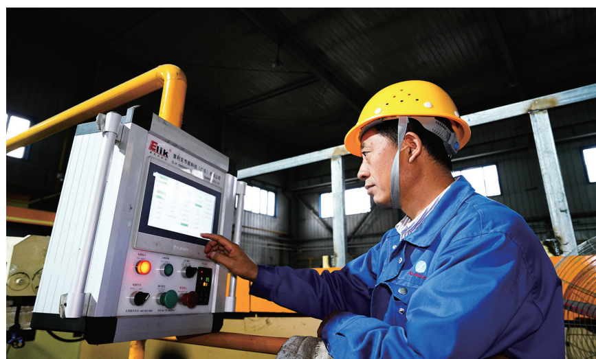
近日，马玉生利用PLC自动化控制系统检查设备运行情况。
