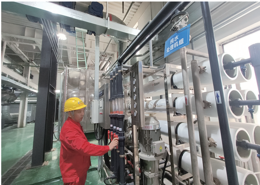
昌吉国家农高区智慧清洁能源热电厂内，工作人员正在查看供热数据。
