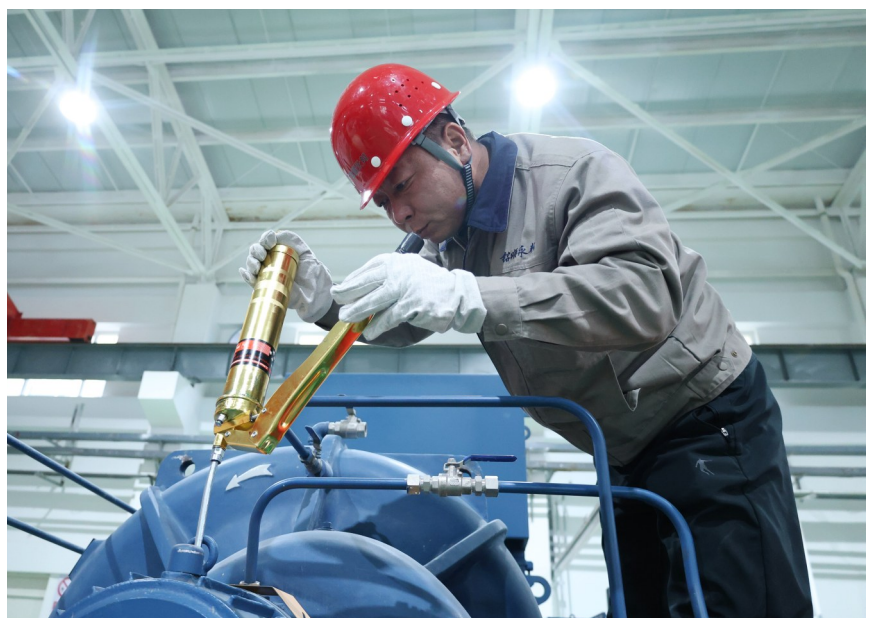
12月10日，在昌吉市新建长输管网供热项目2号中继泵站，工作人员正在保养供热设备。
