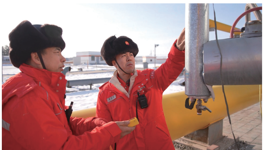
春节期间，新疆油田油气储运公司706站综合巡检班工人巡检维护设备。
