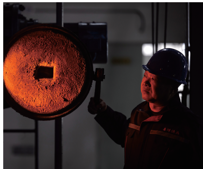
2月15日,木垒县春晖供热有限责任公司,集中供热中心保全班员工在查看锅炉运行情况。 □本报记者 何龙摄
