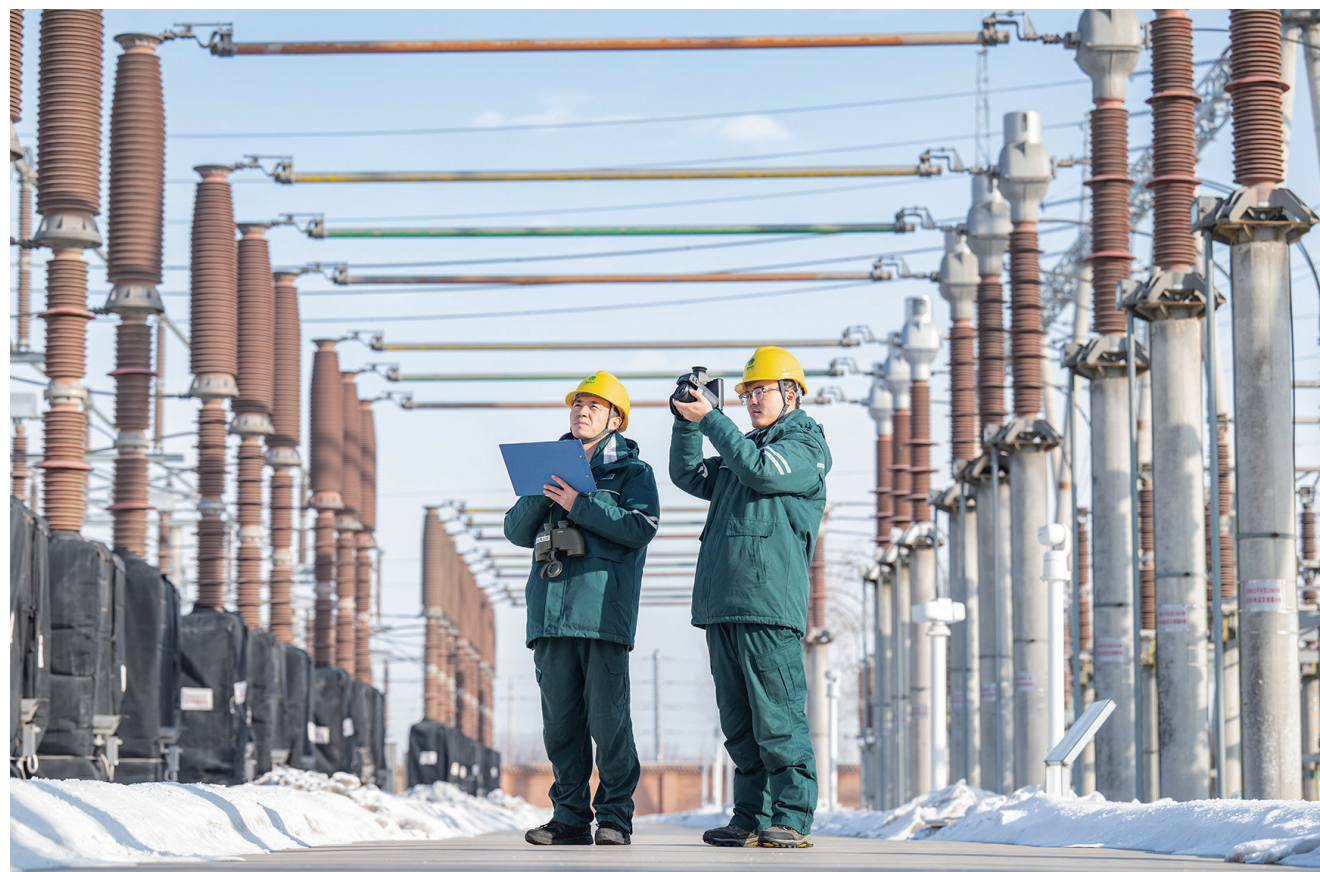
2月17日,国网昌吉供电公司220千伏长宁变电站,变电运维中心值班员在站内巡检。 □本报记者 何龙摄
