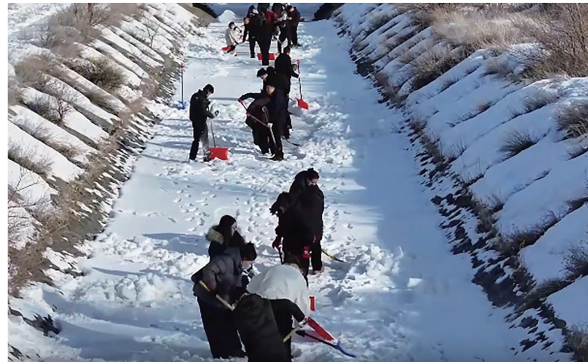
奇台县开垦河渠首下游段闸口，当地水管站干部在闸口冰面进行人工凿冰作业，全力保障河道引水安全畅通。
