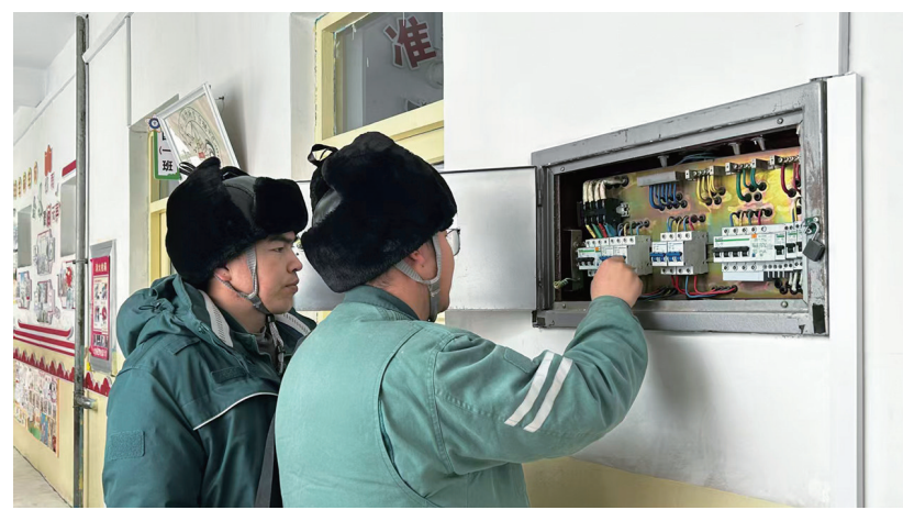
近日，供电公司员工对校园配电设施等进行全面“安全体检”，及时排查消除隐患，保障全校师生用电安全。 □王安琪摄
