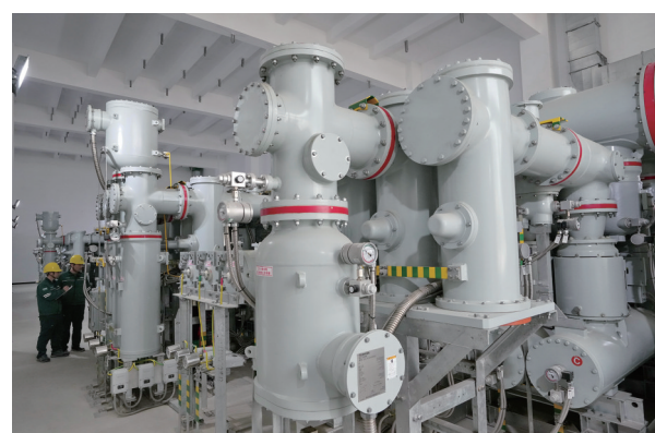
3月24日，国网雄安新区供电公司员工在管西220千伏变电站内巡检。
