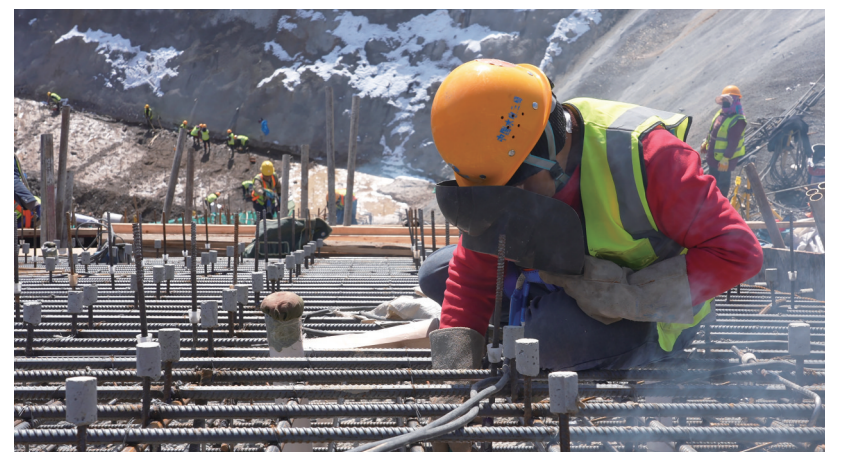
3月26日,阜康市四工河水库项目工人正在焊接大坝趾板钢筋。 □魏聪慧摄
