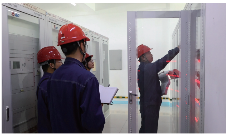
5月15日，在三峡集团新疆分公司吉木萨尔县全钒液流储能电站，工作人员正在查看设备运行情况。
