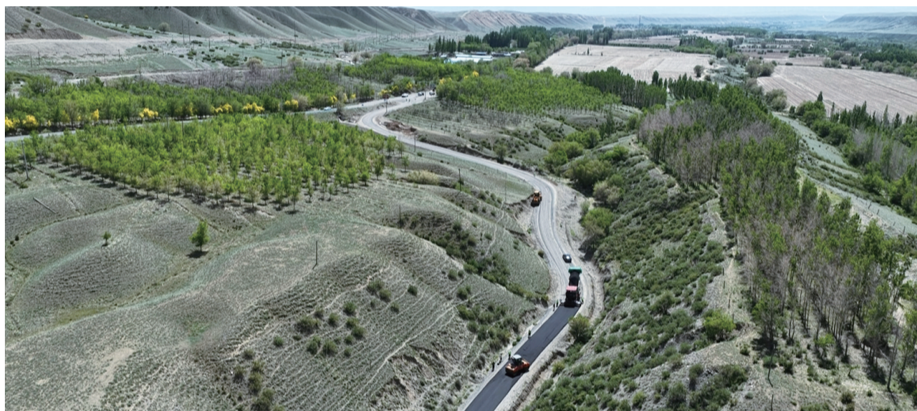
近日，在玛纳斯县塔西河乡红沙湾村，施工人员在铺设沥青路面。 □赵善宾摄
