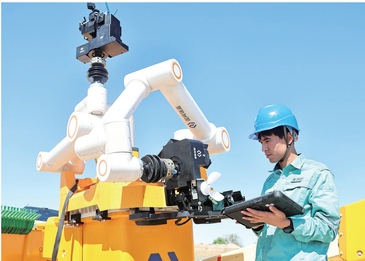
5月18日,国网呼图壁县供电公司工作人员正在调试带电作业机器人。
