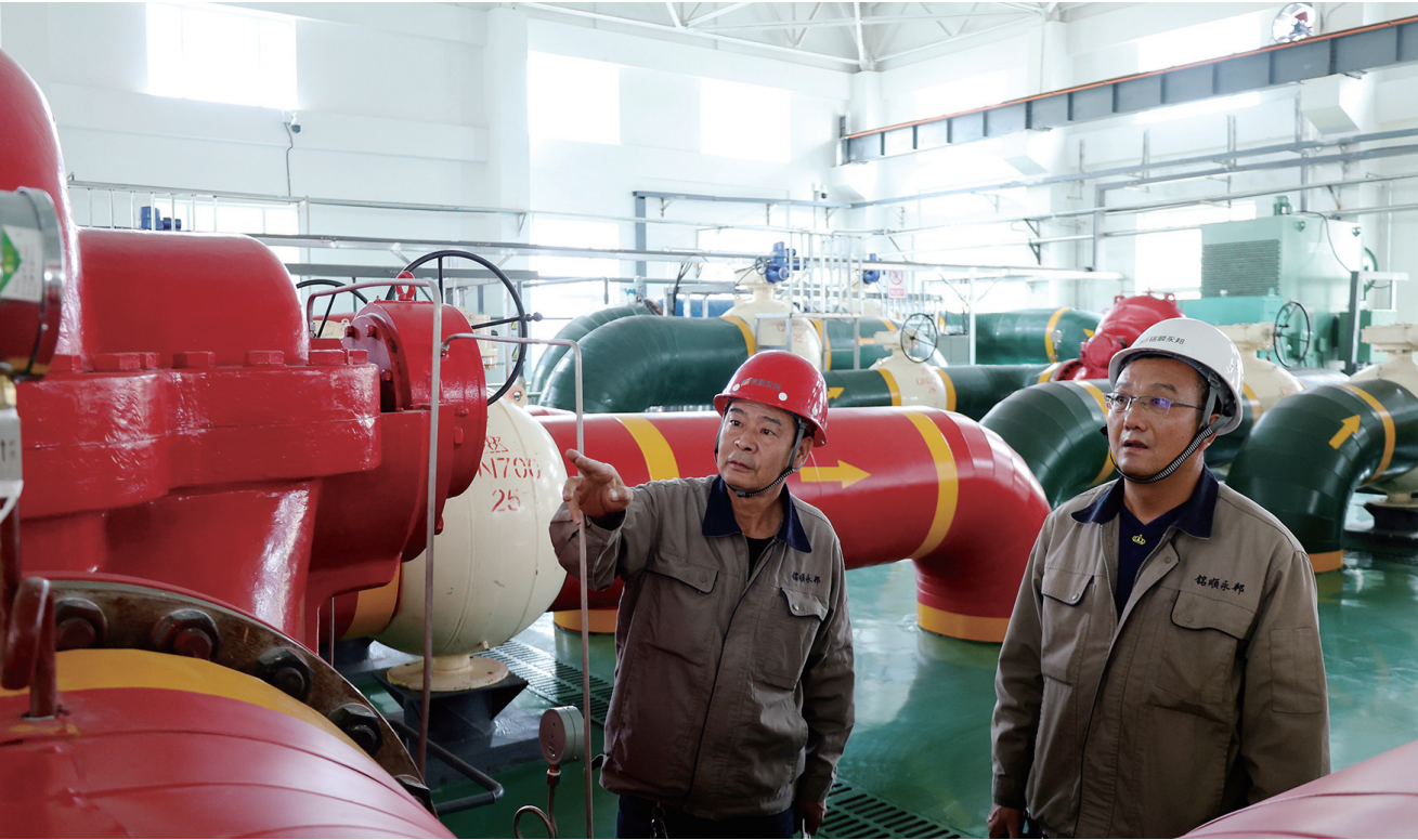
10月14日,在昌吉市新建长输管网供热项目2号中继泵站,新疆铭顺永邦热能有限公司工作人员正在巡查供热设备运行情况。 □本报记者 付小芳摄
